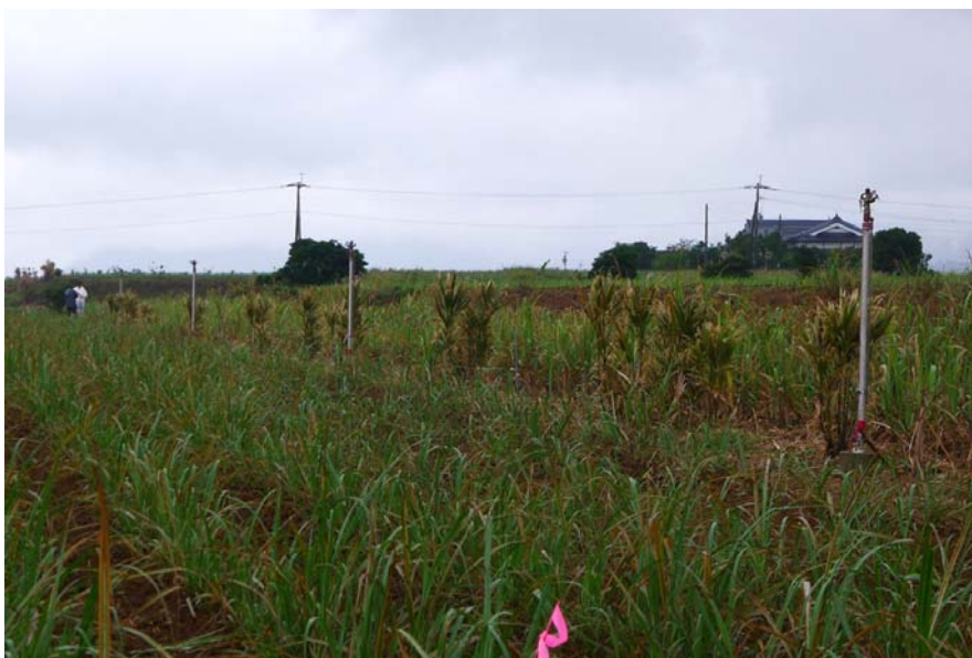
写真1 スプリンクラー設置状況
