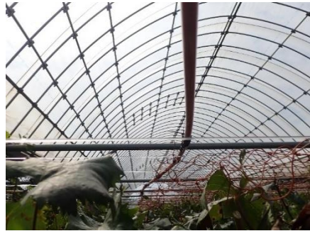
樹脂被覆パイプ曲がり状況
